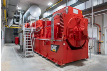
Cat Gas-Stromaggregat des Typs CG260-16 (© Pfalzwerke)
